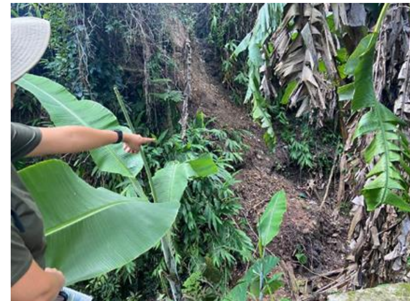
Deslizamento próximo à ponte de ferro
