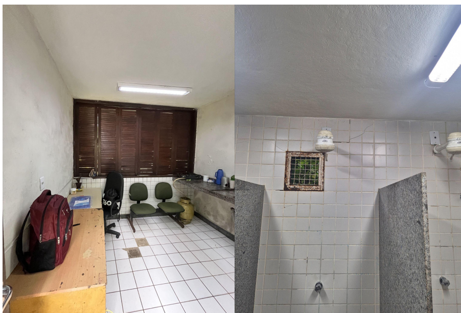
Figura 4-12 Lanchonete Pilar com infiltrações e vestiário com fissuras no revestimento
