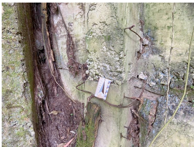
Figura 6-34 Instalações do muro com vergalhões expostos.
