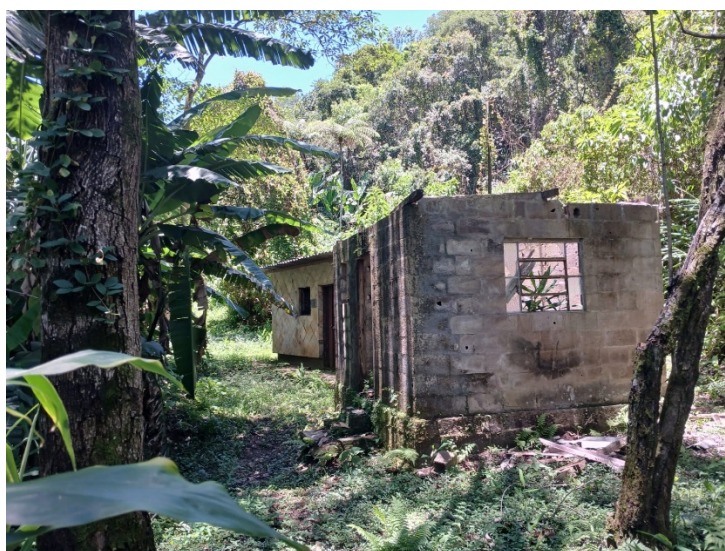
Figura 5-39 Casa de Bombas
