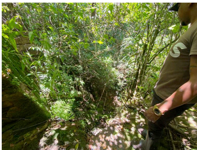
Figura 6-12 Visada para a depressão do deslizamento.
