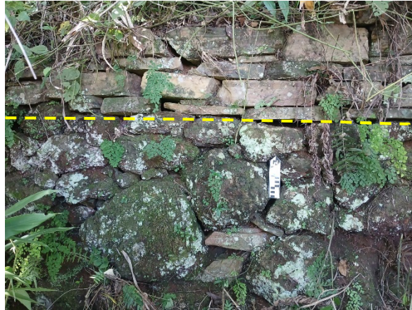
Figura 3-5 A linha traceja indica recente intervenção estrutural no muro
