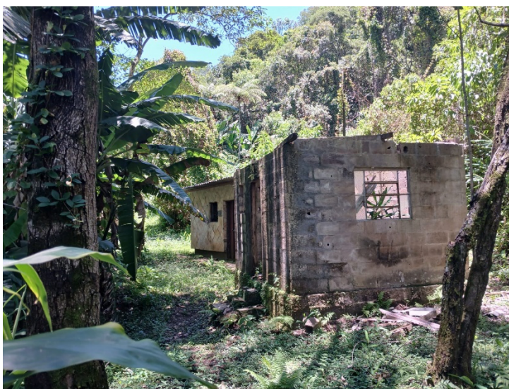
Figura 3-37 Casa de Bombas
